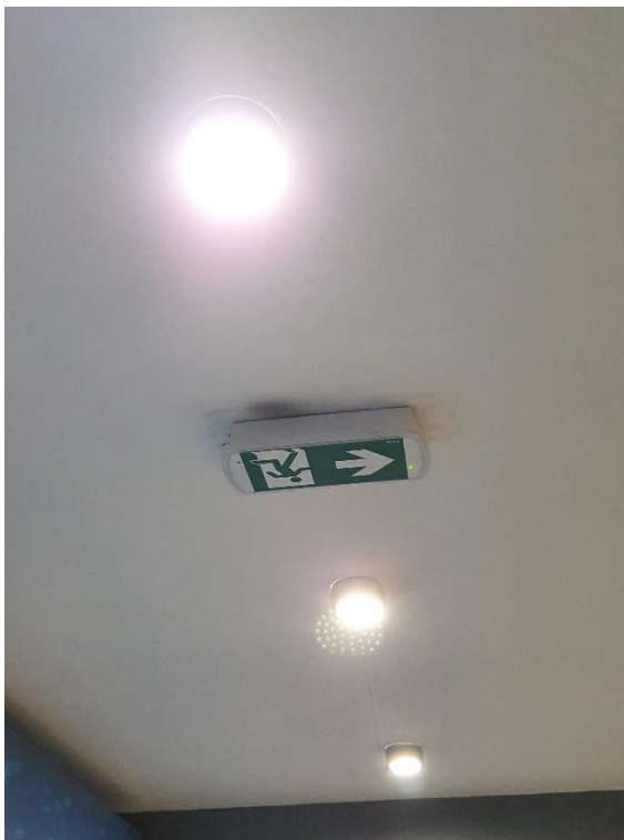
Slika 29: Nadgradna rasvjetna tijela
