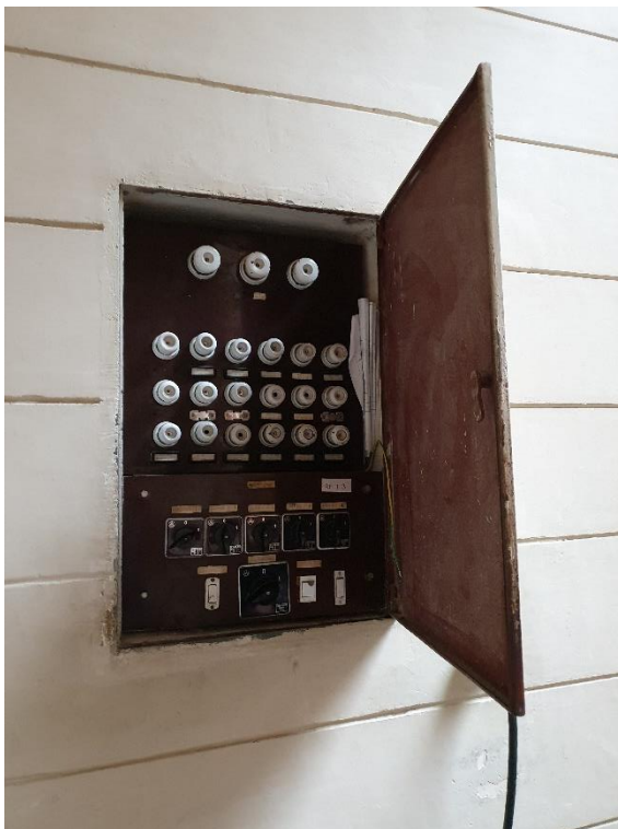
Slika 25: Razvodni ormar sa topivim osiguračima
