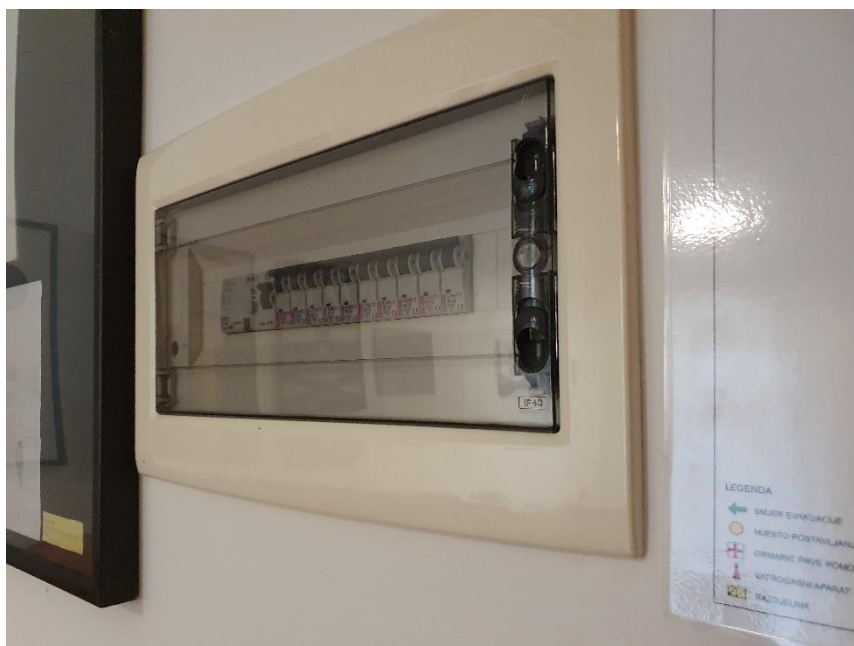
Slika 26: Priključni ormar sa automatskim osiguračima
