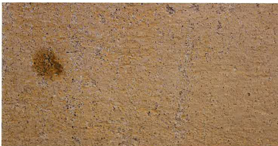
Detalj sonde 4 na stropnoj ravnoj plohi, vidljiva je oker boja
