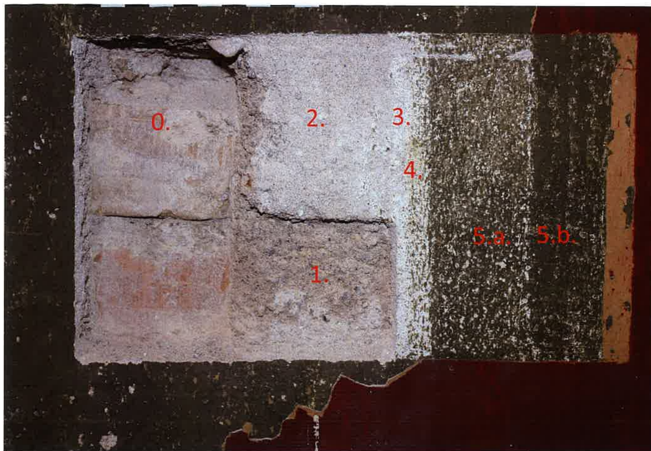
Detalj sonde 1 na sjevernoistočnom zidu Salona, vidljiv je slabo očuvan prvi oker nalič nanesen na podlozi bijele boje
