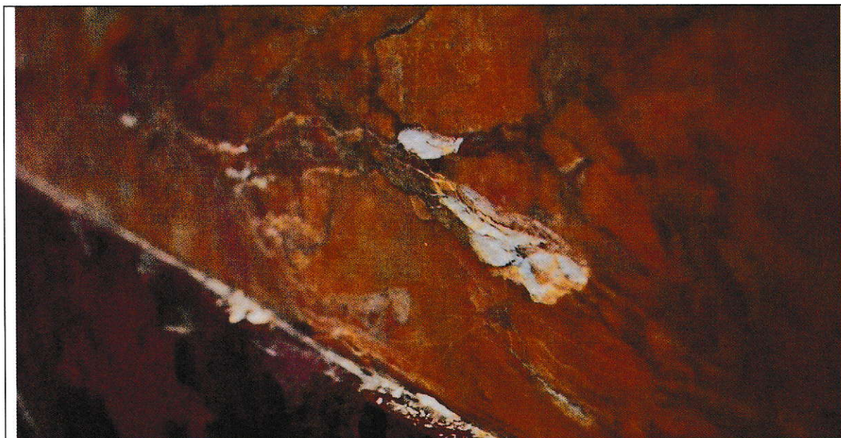
Sl. 5 Soli razaraju strukturu mramora, ljuskanje i praskasto osipanje – detalj na sjevernom zidu
