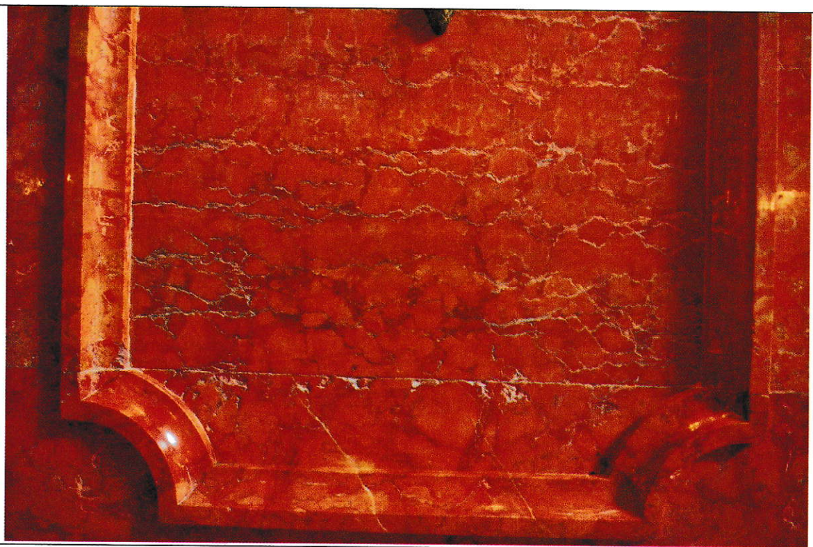
Sl. 8 Degradacija površine mramora Rosso Verona – detalj na sjevernom zidu
