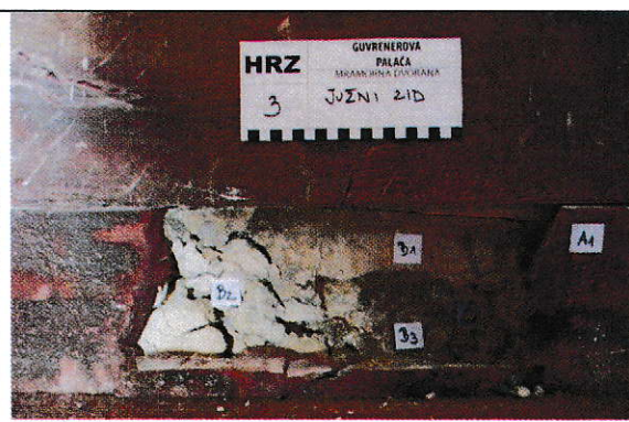
Sl. 40 Sonda ispod odlomljenog dijela profilavije na južnom zidu
