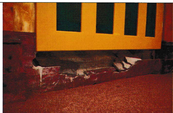
Sl. 28 Odlomljen mramor usljed montaže radijatora na istočnom dijelu sjevernog zida
