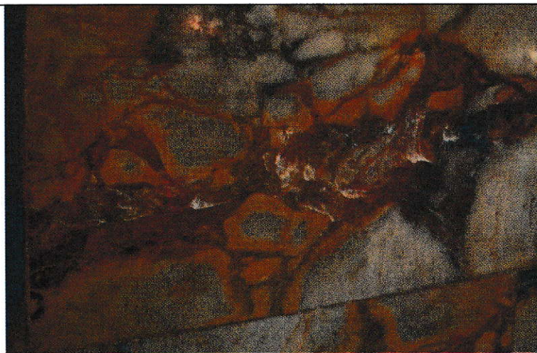
Sl. 4 Osipavanje površinskog sloja - detalj na sjevernom zidu
